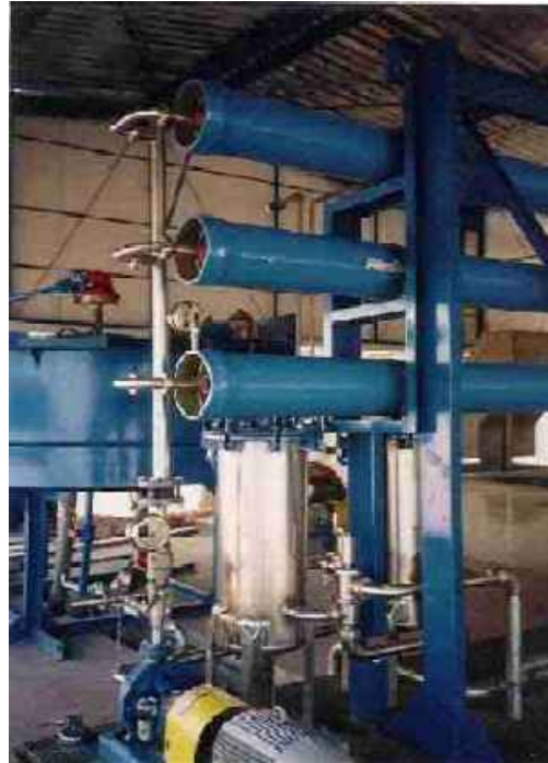
Unidade de OSMOSE REVERSA - Produção de Água Desmineralizada - Tratamento de Águas de Efluentes
